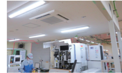
工場のLED照明
